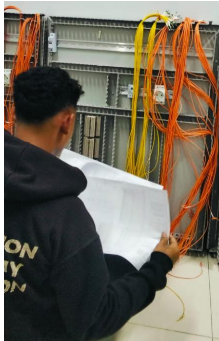
Gambar 3. Mahasiswa sedang membaca gambar teknik dan mengurutkan kabel pada pebl box PLC.
